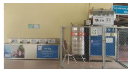
設置した浄水器の写真
